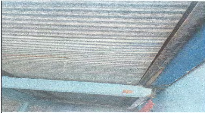
Foto 1: Se muestra fotografía de la lamina del modulo No. 1 que ya se encuentran muy dañadas y con agujeros ya que están desde el años 1992. El área a sustituir es de 108 Mts2
