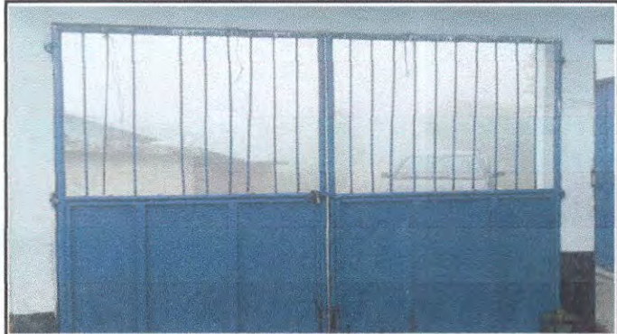
Foto 8: Se muestra fotografía del portón principal del centro educativo, que necesita ser reparado como se le debe cambiar toda la parte superior
