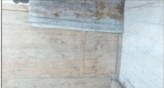
Foto 10: Se muestra fotografía de un muro perimetral que no es adecuado para que los niños puedan recibir clases, el área a cambiar es de 25 Mts.2
