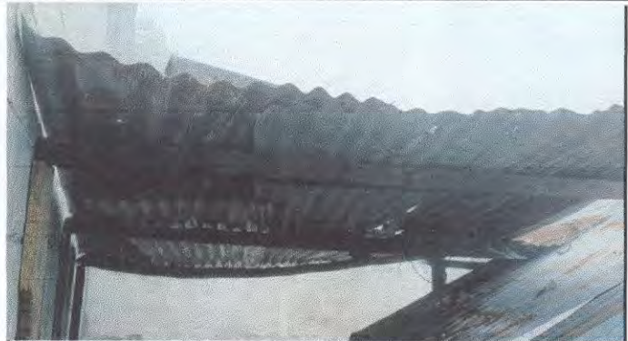
Foto 2: Se muestra fotografía de lamina y estructura de madera en condiciones no aceptables el área a cambiar es de 63Mts.2
