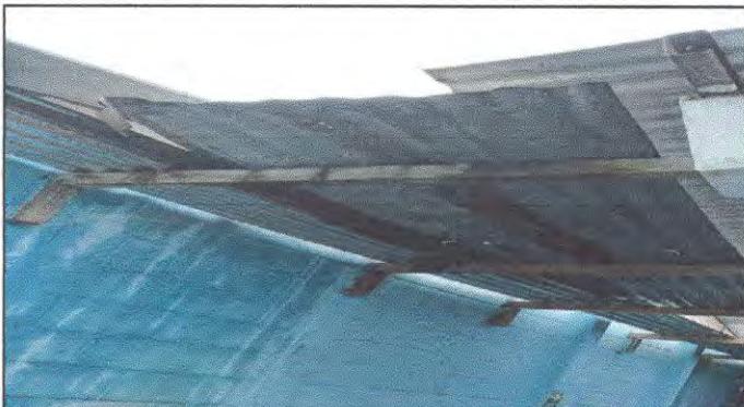
Foto 3: Se muestra fotografía de lamina y estructura de madera donde se filtra el agua ya que tiene mas de 10 años de estar, por tal razón se encuentra deteriorada. El área a cambiar es de 63 Mts2.
