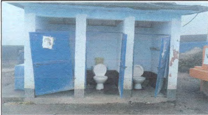
Foto 7: Se muestra fotografía de tres puertas de los servicios sanitarios que ya no se encuentran en buen estado y que necesitan reparación para que sean usados los servicios sanitarios
