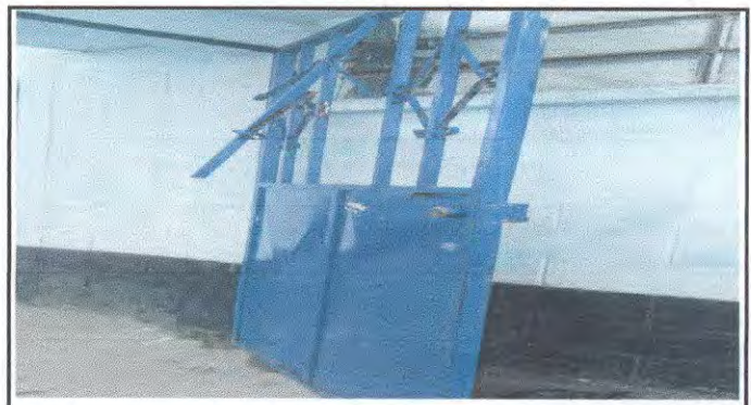
Foto 4: Se muestra fotografía de la puerta principal de la escuela que se encuentra dañada ya que tiene mas de 15 años de antigüedad por tal razón tiene que ser reparada
